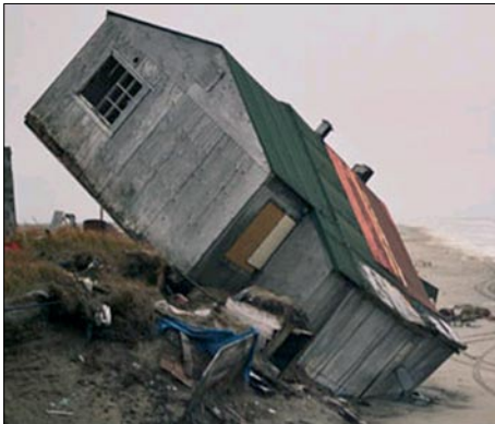
Gekipptes Haus durch auftauenden Dauerfrost-Boden in Alaska.
